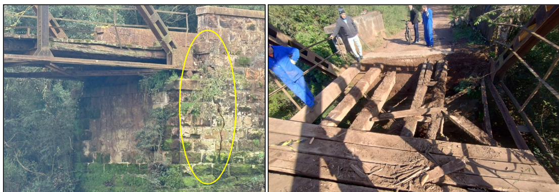
Fig. 3: Imagens do encontro de uma das cabeceiras de uma das pontes e detalhes de suas vigas colapsadas
