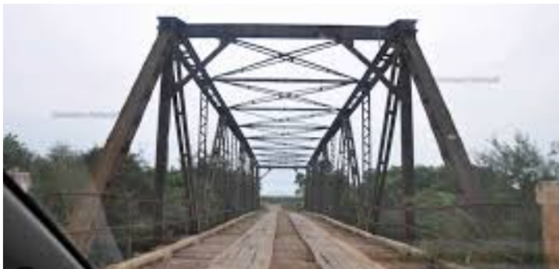
Fig. 2: Vistas frontal da ponte na ERS-507, com extensão original de 58 m antes do sinistro
