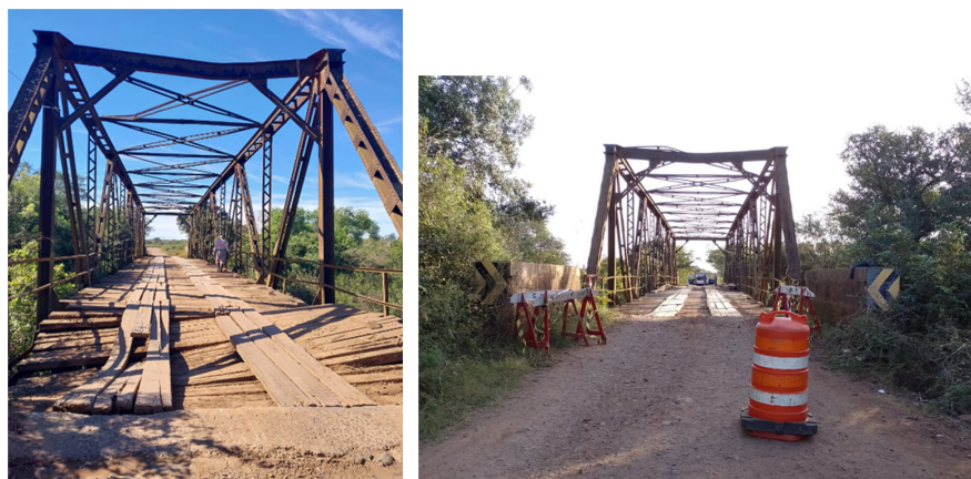
Figura 2.1: Ponte sobre o Arroio Capivari com fluxo interrompido no Município de Alegrete
